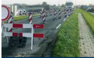
03 Help, de Maasdijk verzakt
